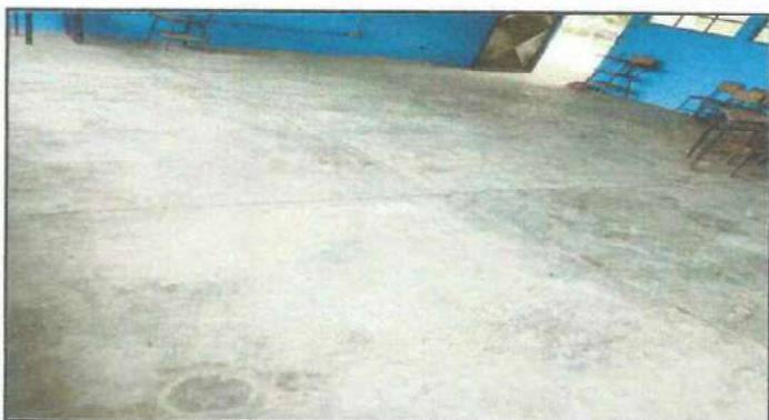
Se evidencia la necesidad se sustituir el piso de torta por piso ceramico modulo III
