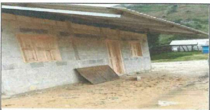
Foto 5: Se evidencia la necesidad de implementacion de piso de torta de concreto en el corredor de la cocina
