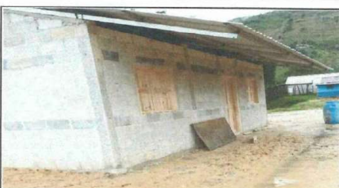
Foto 4: Vista de la cocina del establecimiento donde de urgencia la sustitucion de puerta y ventana madera por metal
