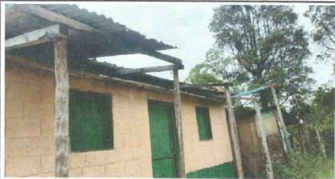
Foto 1: Vista frontal del del Establecimiento donde se refleja el mal estado en que se encuentra el entechado del mismo (laminas y paredes). Módulos I
